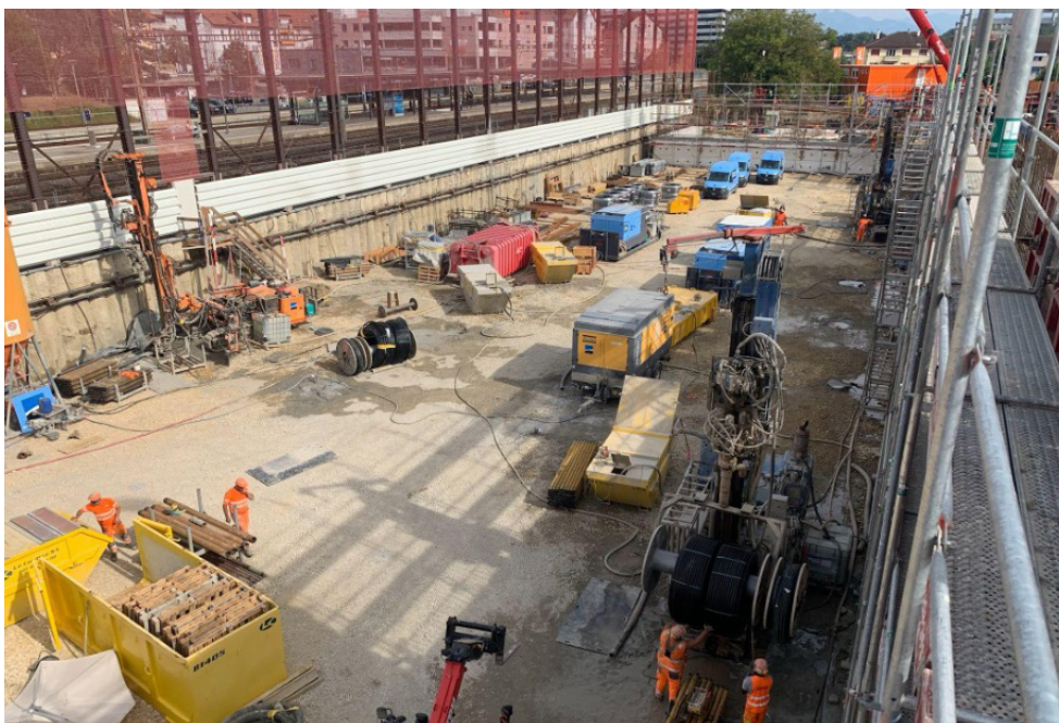
Gambar 8.6: Tim pembuat sumur bersiap untuk mengebor serangkaian sumur panas bumi dangkal untuk menyediakan sistem pemanasan dan pendinginan skala komersial di kawasan perkotaan Lausanne, Swiss. Sumber foto dari Groupe Grisoni.
